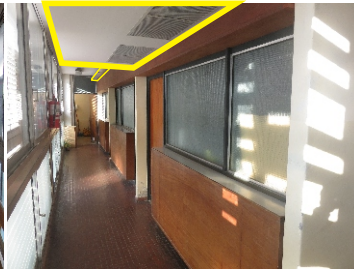
16) Circulación personal - detalle de los cajones superiores de las cañerías del sistema VRV y bandejas metálicas con instalación eléctrica.
