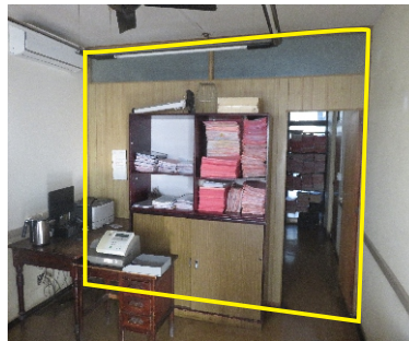
8) Tabique de madera con revestimiento con Corlock a reemplazar en el Juzgado de Circuito.
